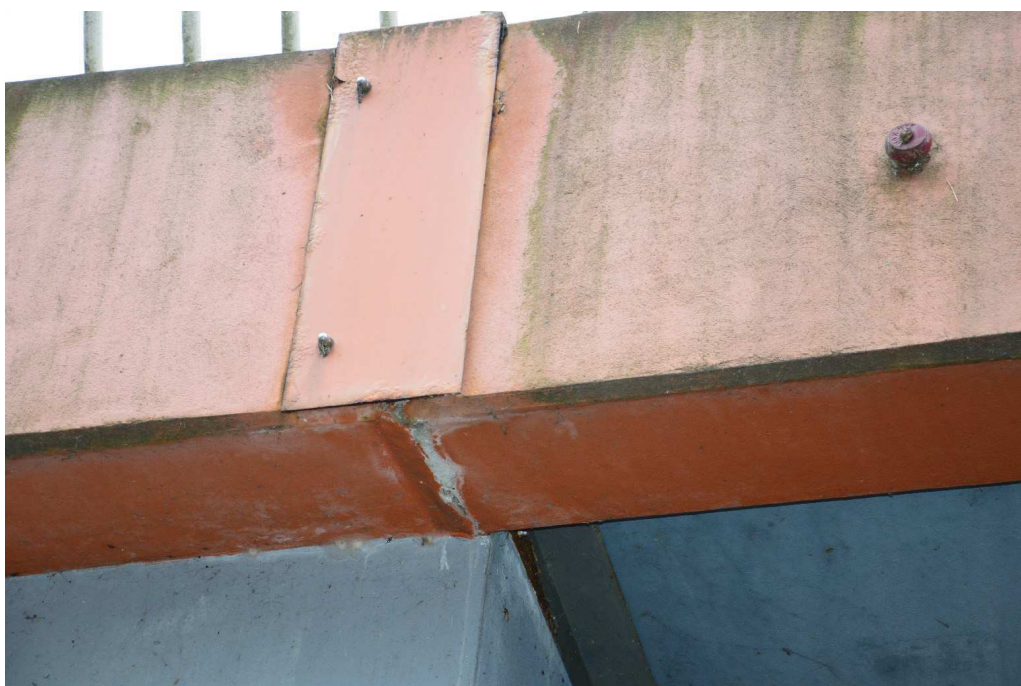
Fot. 12 Szczelina dylatacyjna na spodzie ustroju nośnego
