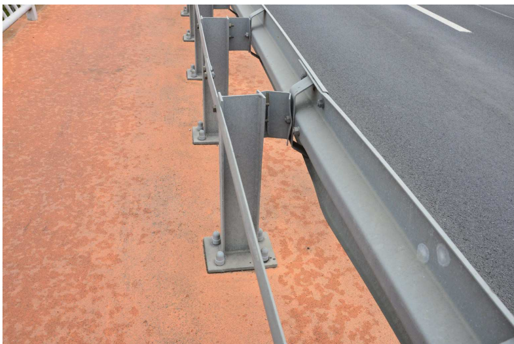
Fot. 8 Bariera na obiekcie
