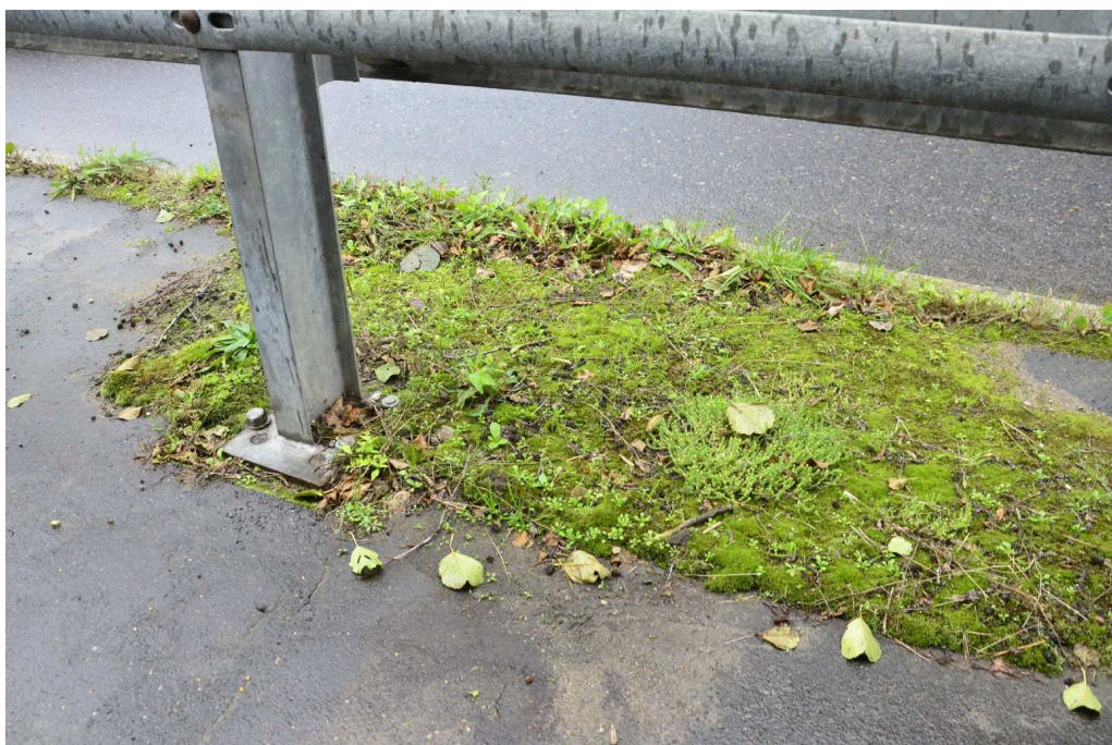
Fot. 7 Nawierzchnia chodnika na obiekcie Rozległy porost traw i mchów na nawierzchni chodnika.
