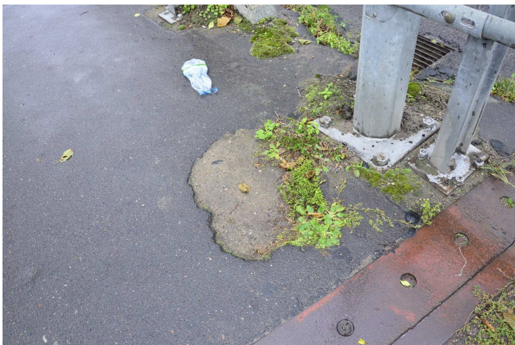
Fot. 6 Nawierzchnia chodnika
