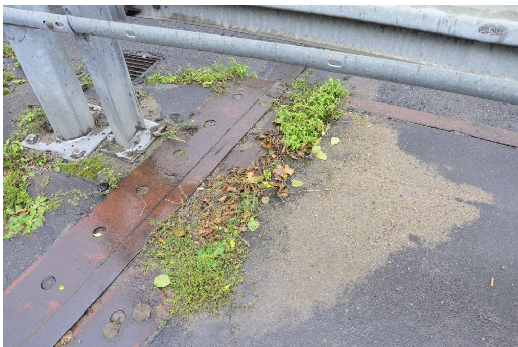
Fot. 12 Urządzenie dylatacyjne w chodniku
