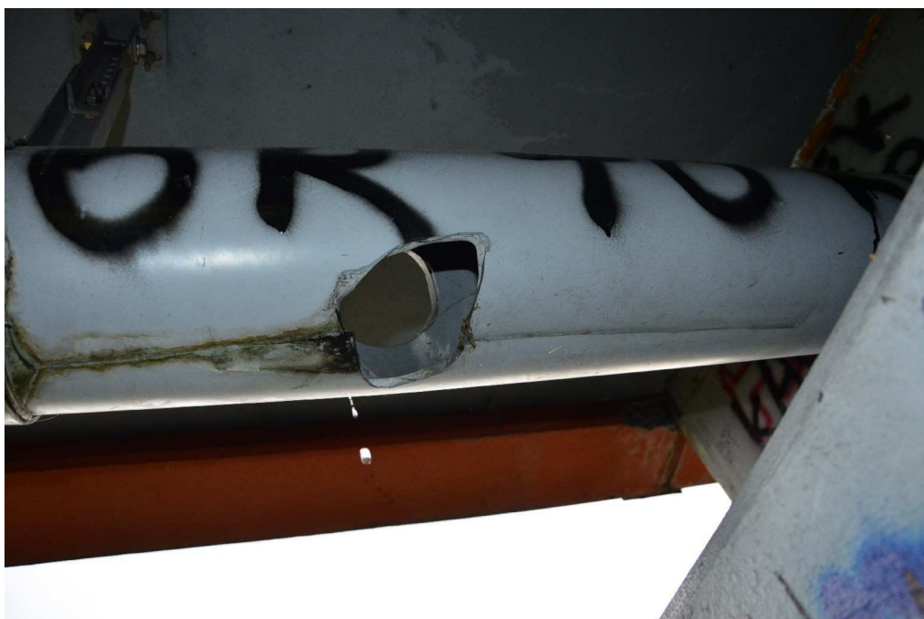
Fot. 12 Instalacja odwodnienia
