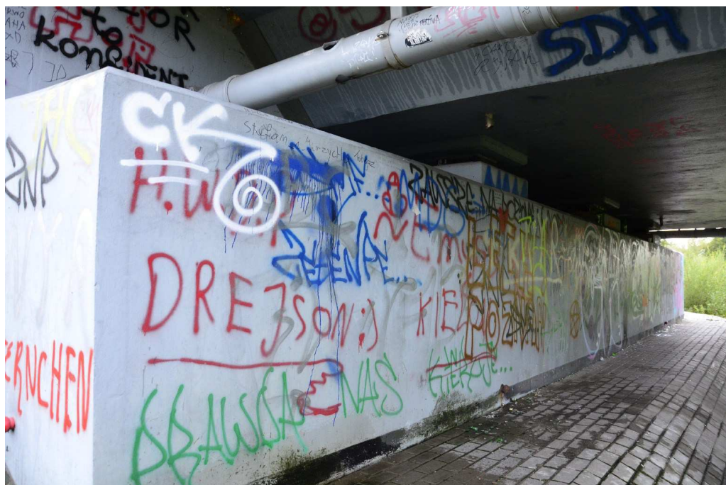
Fot. 15 Przyczółek estakady Graffiti na powierzchni przyczółków.
