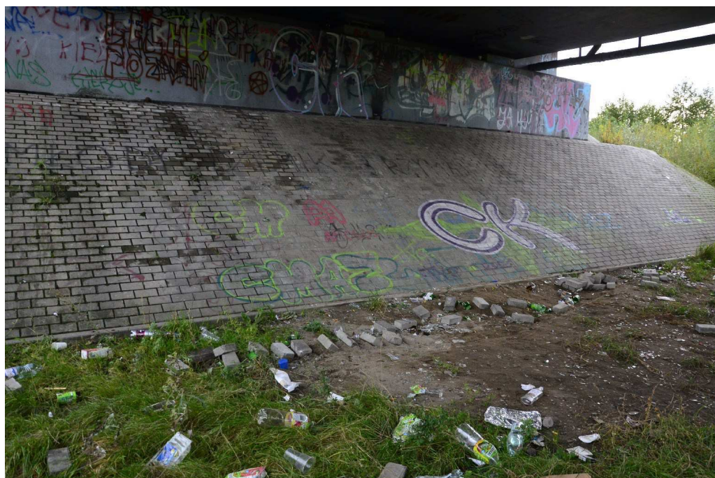
Fot. 16 Teren pod obiektem Bardzo silnie zanieczyszczony śmieciami teren pod obiektem.
