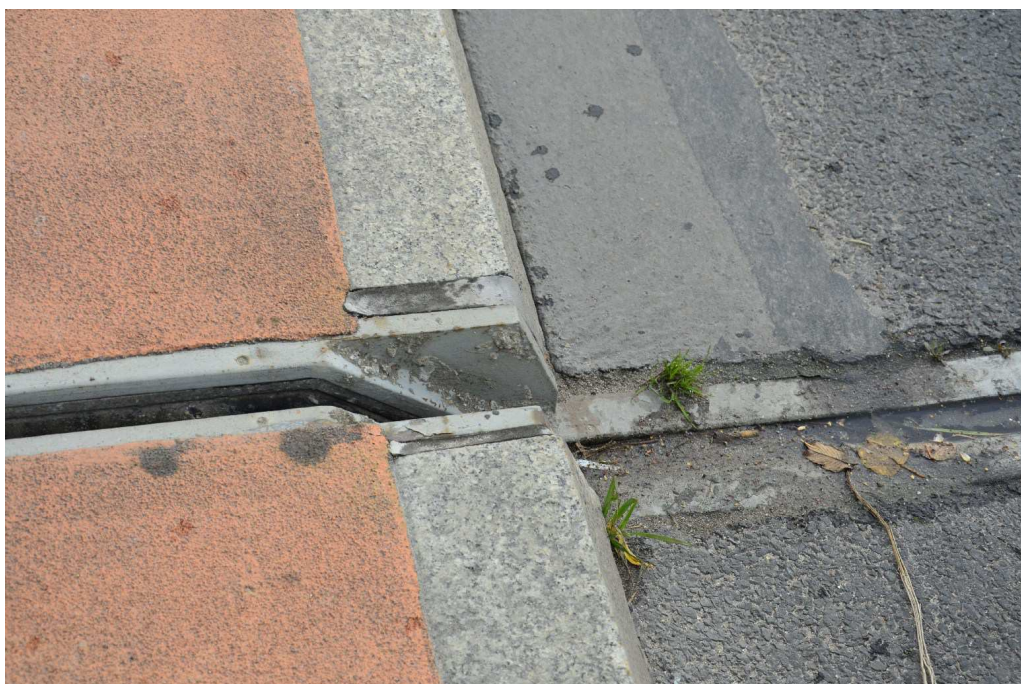
Fot. 5 Modułowe urządzenie dylatacyjne w chodniku Silne zanieczyszczenie piaskiem urządzenia dylatacyjnego w strefie krawężnika. Porost roślinności w urządzeniu.
